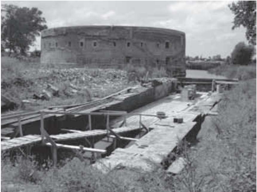
Afb. 6. Uitzicht op de in restauratie zijnde sluisverbinding en het fort. (Foto: auteur, juni 2007.)
