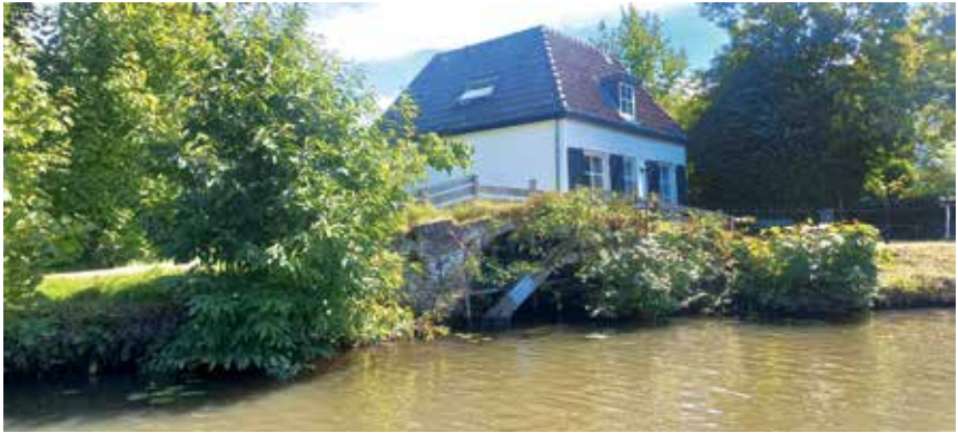
Afb. 8 Het in slechte staat verkerende bruggetje in het jaagpad te Maarsse.
