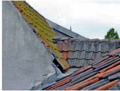
Afb. 6 Zicht op de geveltop met het zadeldak achter het fronton van de voorgevel. Tegen het witgepleisterde muurdeel bevond zich oorspronkelijk de toren.
