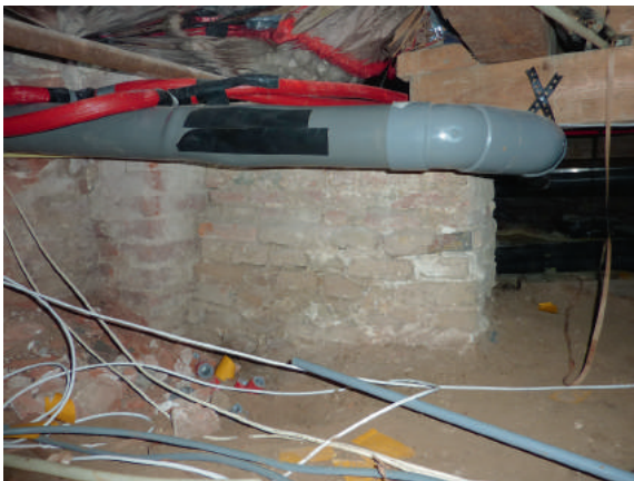
Afb. 4 Zicht op de funderingen van de linkerschouwvang in de kruipruimte onder de zaal. Deze bestaat uit twee fasen.
