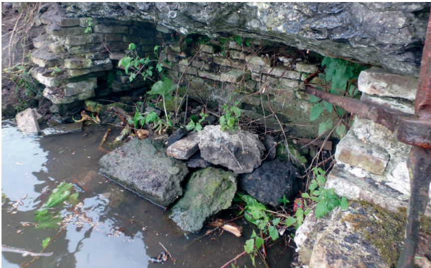
Afb. 2 Detailopname waterstoep tijdens het vooronderzoek. (Foto: EJBouwadvies Ederveen)
